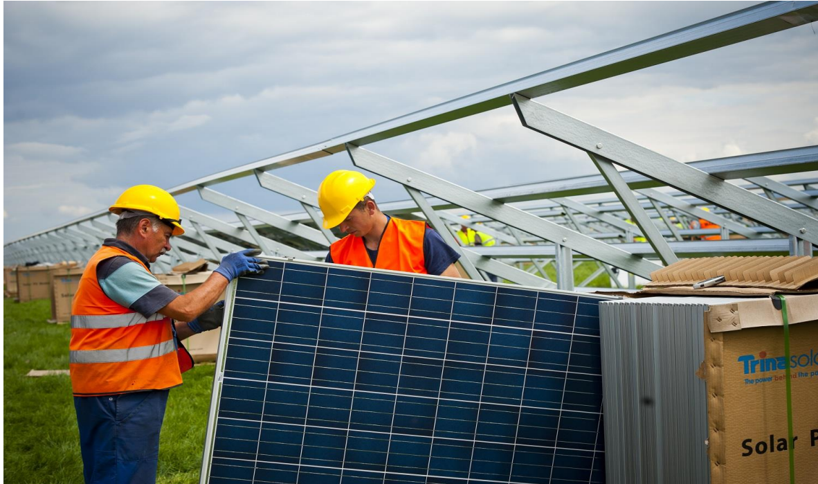
Zdjęcia. Budowa farmy solarnej Bautzen (Niemcy) 310MW na powierzchni ok. 70ha przez polską firmę Remor Solar z Recza (Remor Solar)
