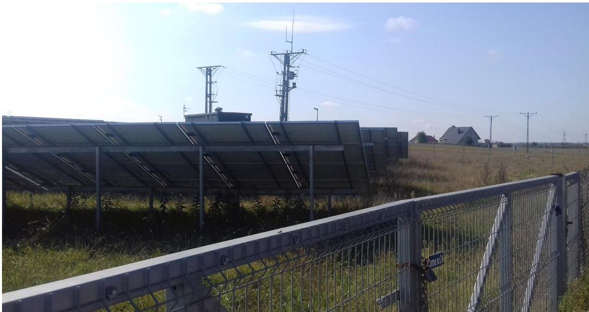
Zdjęcie. Przykładowe ogrodzenie wraz z systemem alarmowo – monitoringowym na farmie PV pod Lublinem (M. Szlaps)
